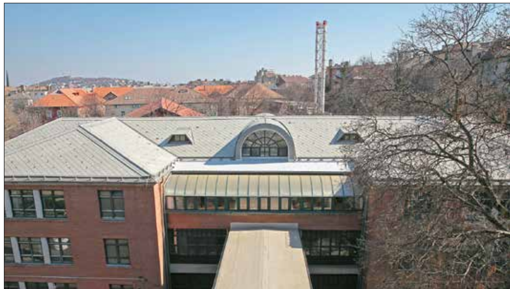
A tető- és strangfelújításnak köszönhetően megszűntek a beázások és a dugulások a Németvölgyi iskolában
